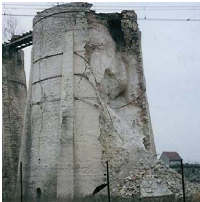
Fot. 5.12 Piec nr 4. Awaria budowlana części płaszcza zewnętrznego 2003r.
