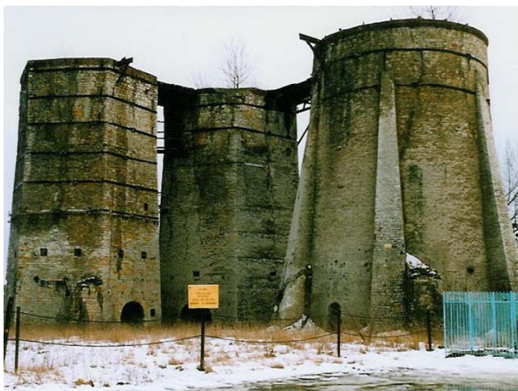
Fot. 5.19 Piece 5, 6, 7. Widoczne liczne spękania płaszcza zewnętrznego oraz znaczne zawilgocenie budowli. Widok od strony północno- wschodniej
