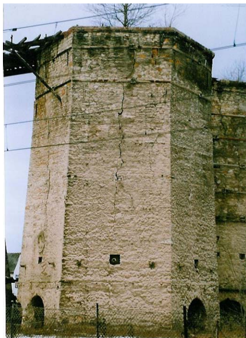
Fot. 5.22 Piec nr 6. Zarysowany płaszcz zewnętrzny, widoczny wlot przewodu wentylacyjnego
